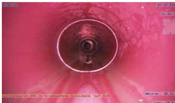
Šachta 34 - Ovalita - zmáčknutí potrubí, je vidět celá tloušťka potrubí
