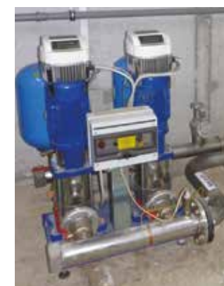
VDJ – přítok do vodojemu a ATS
